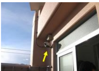
【防犯カメラの設置】
