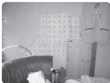
熊本地震にて壁が崩れた部屋
