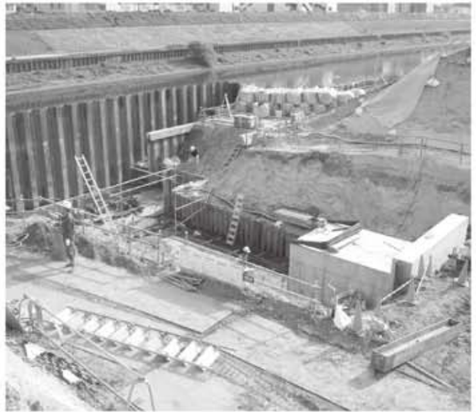
久地野排水区のポンプ場整備
