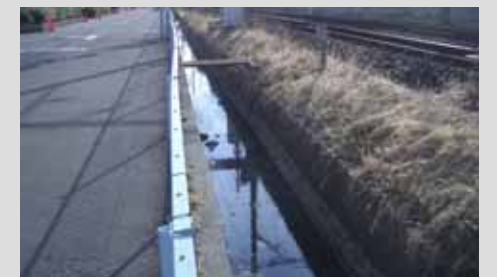
写真① 鹿田第 1 公園付近の用水路
