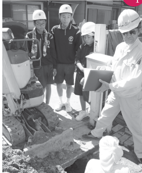
師勝中学校の生徒が職場体験学習で 下水道の工事現場を見学しました。
